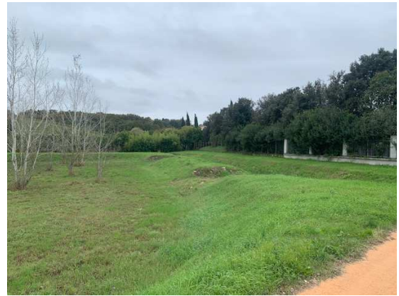
Soglie di sfioro della cassa di laminazione lungo Fosso A
