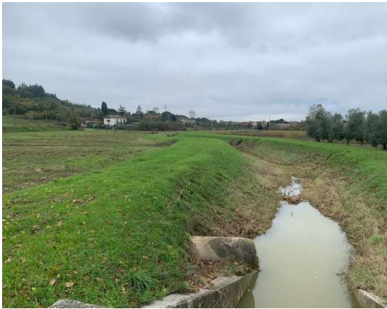
Inizio del tratto arginato a valle di ponticello, con scarico in sinistra
