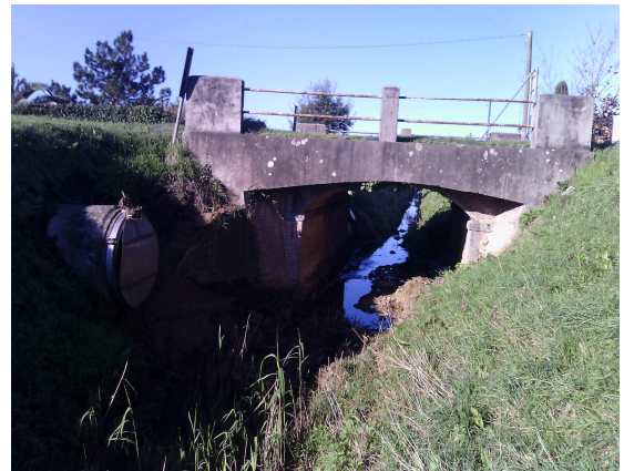
Attraversamento sulla SR 436 con scarico dotato di valvola a clapet (difettata)
