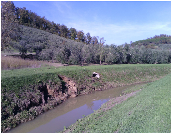
Particolare scarico e dissesto arginale
