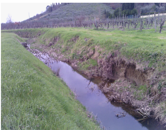
Tratto di monte in dissesto
