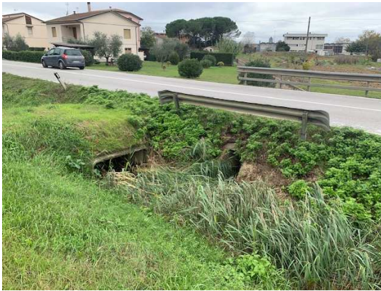
Nodo di attraversamento della SR 436 (confluenza tra Fosso B e Fosso A)
