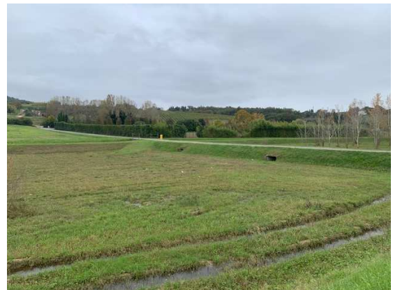
Particolare della cassa Nord e dei tombini di collegamento con la cassa Sud
